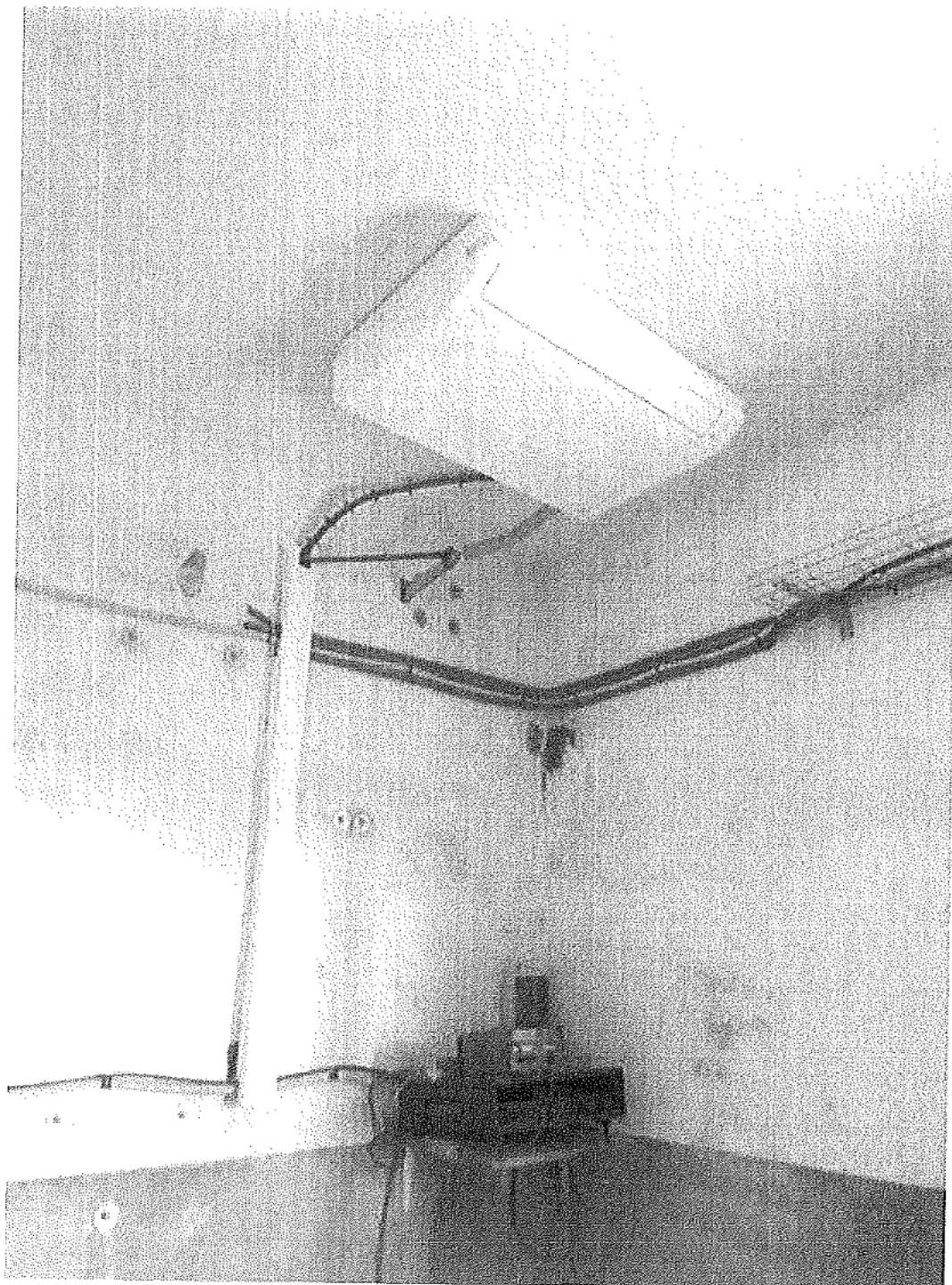
Foto 4. Aire condicionat a la sala
