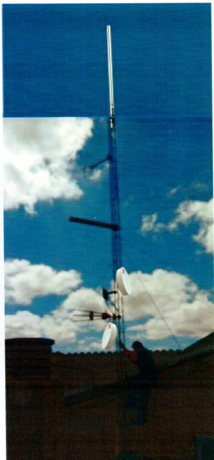
Fotomuntatge 1. Elements a la torre de telecomunicacions
